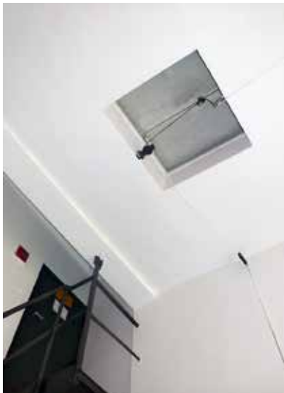
Eine zeitgenössische Rauchklappe, über Seilzug und Hebel manuell im obersten und Erdgeschoss öffnen- und schließbar
